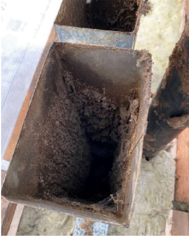
Bilde 9: VS 3, ventilasjonskanaler trenger rens.
